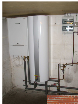
Typisk installation med 12 Kw varme-veksler og 160 L spec. varmtvandsbeholder.
