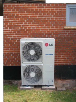
12 Kw udedel, står og stjæler varmen fra udeluften. ”Støjer” som en PC’er.!
